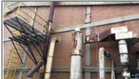
FOTOGRAFIA 6. CICLONES, PRECIPITADOR ELECTROSTÁTICO Y DUCTO DE DESCARGA CON PLATAFORMA DEL PROCESO DE TOSTIÓN.
